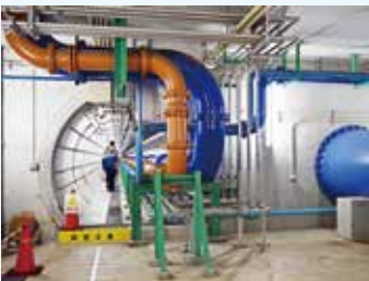
沈砂池管理棟と水処理施設をつなぐ地下管廊
